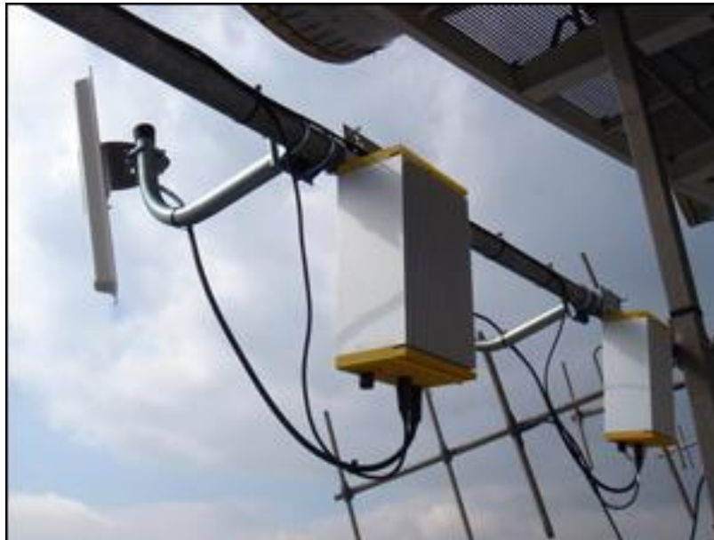
Detalle de los dispositivos instalados
