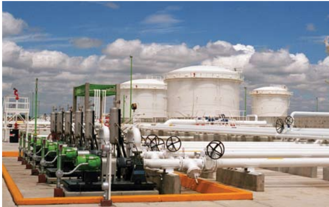
Vista parcial de la planta de almacenamiento de Aguascalientes, Gerencia de Comunicación Social, Pemex.
