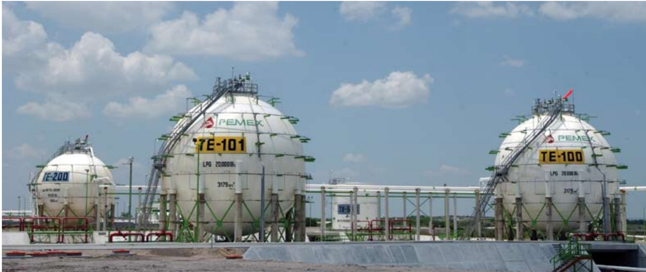
Tanques contenedores para gas en la planta de Reynosa, Gerencia de Comunicación Social, Pemex.
