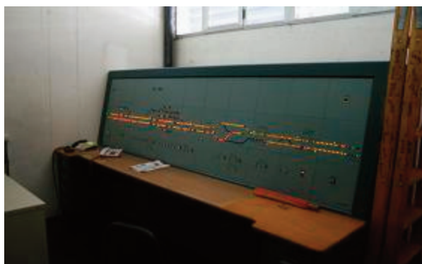
Fig. 3. Puesto de mando Local (PML) del Enclavamiento de Sant Boi
