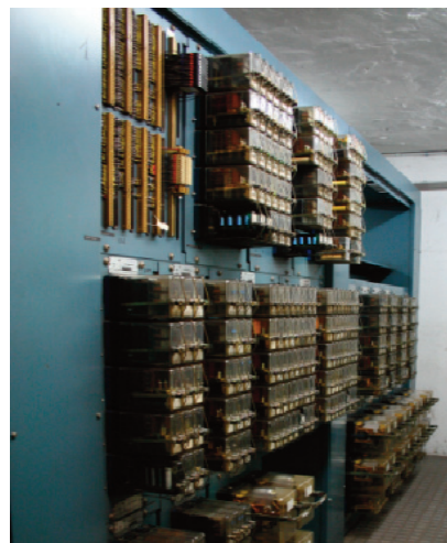
Fig.2. Cabina de relés de un Enclavamiento de Módulos Geográficos
