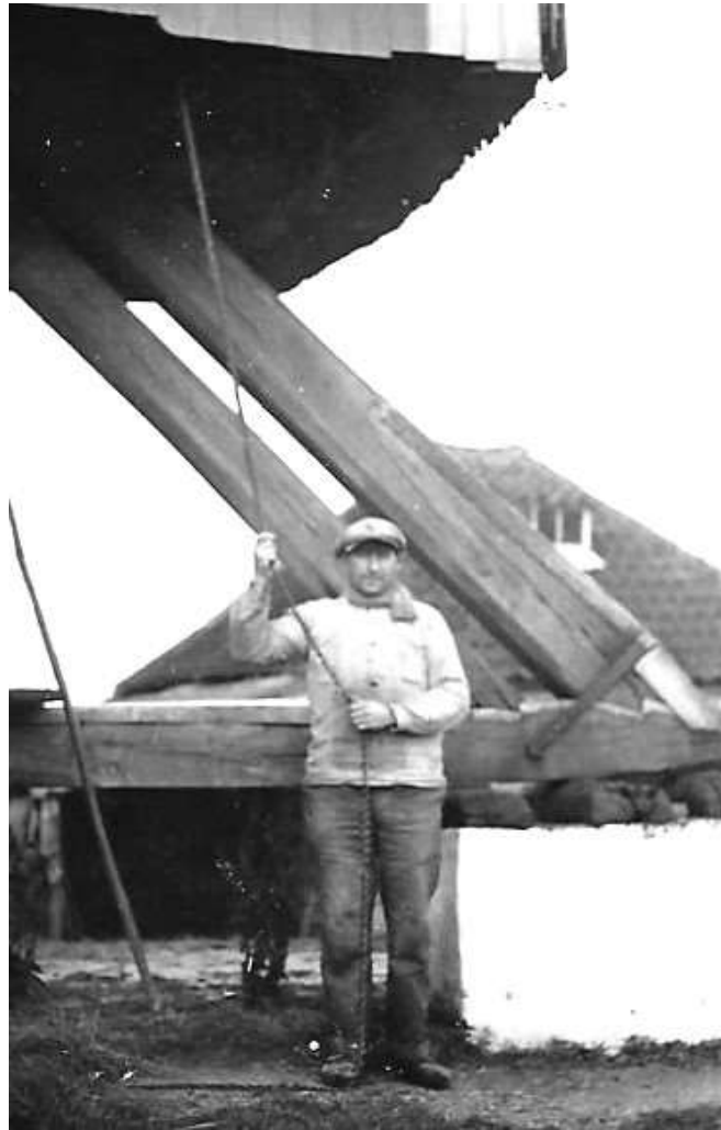
Étrier assujettissant le lien à la sole du moulin de Houtave (Fl.-Occ.). Photo Ch. Devyt. Cf. : au fevre de Phalempin, pour avoir livré deux estriez de fer aux loiens pour acoler les croisures affin qu'ilz ne se separassent point des croisures, pesans 56 livres de fer (✕Attiches 1470).
