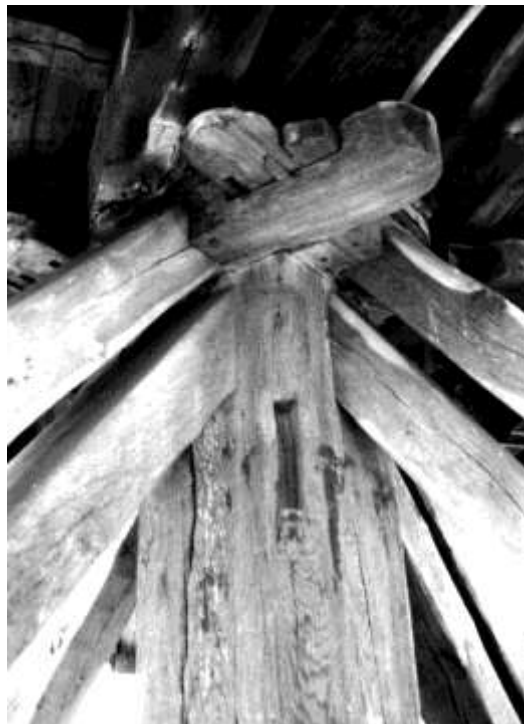
Pivot, liens et chaise du moulin de Wehe (Rhénanie du Nord-Westphalie). Mortaise dans le pivot à l'emplacement d'un ancien faux-lien. Photo J. De Punt
