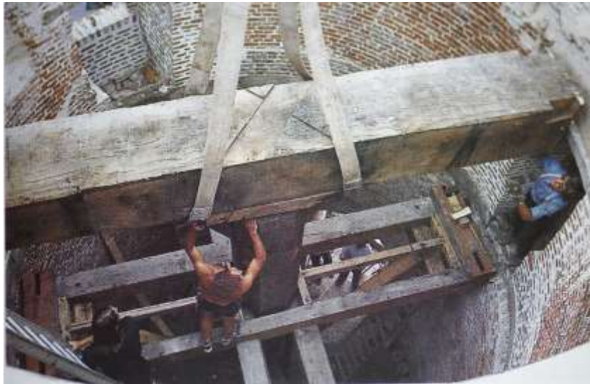
Moulin de Vertain à Templeuve en cours de restauration (1982). Vue sur les trattes du premier plancher, sur lesquelles se tient un ouvrier pour la mise en place du maître-sommier. Photo J.B.
