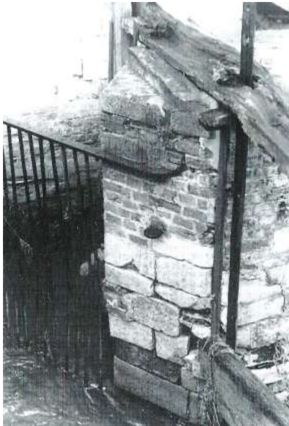
Moulin de Grimbergen (Brabant flamand). Jauge en métal dépassant la maçonnerie au milieu de la largeur du mur, entre les pierres et les briques, indiquant le niveau d'eau à ne pas dépasser. Photo P.B.
