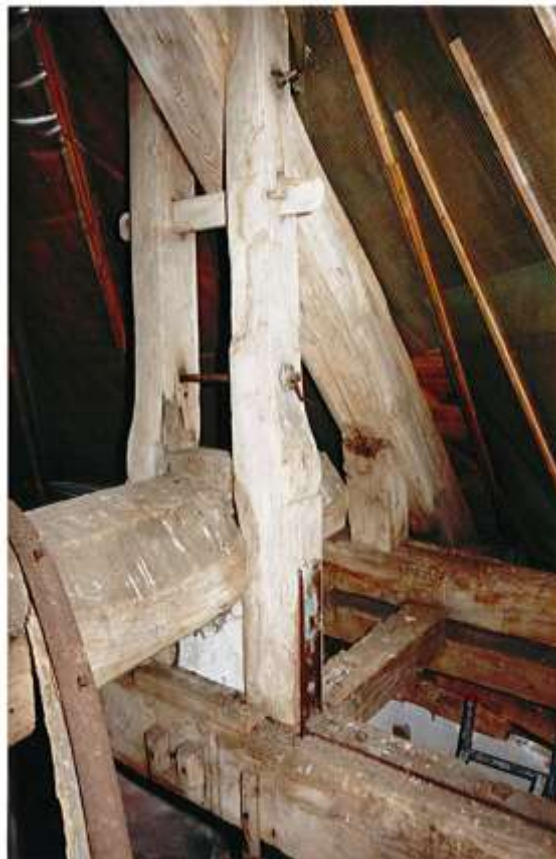
Moulin de Montceau-et-Écharnant (Côte-d'Or) : quenolle servant de support à la queue. Photo J.B.
