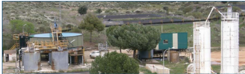
Plantas de tratamiento de aguas
