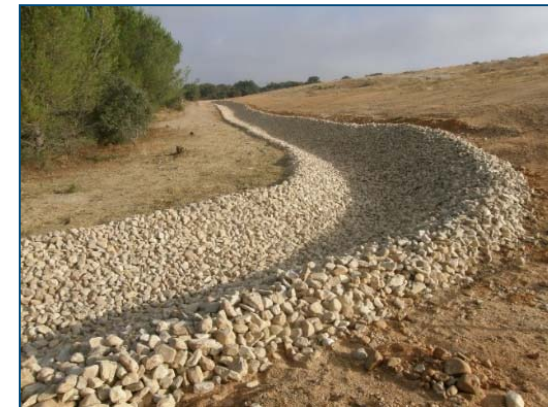
Actuaciones de estabilización in situ (protección de cauces y vaguadas, reparaciones de la multicapa de protección, etc.)
