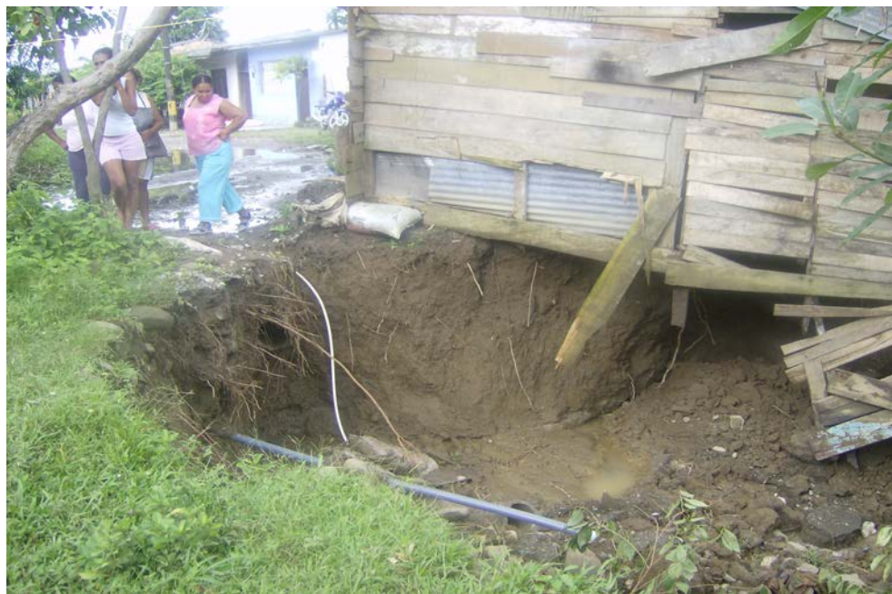
Foto No 7. Construcciones ubicadas en el borde del talud. Falla por vertimientos de aguas Barrio Gaitán y Jardín
