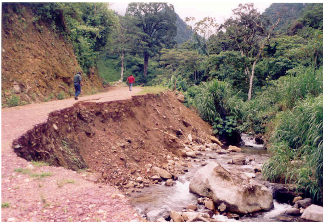
Afectación por el arroyo Sayuch, Km 4+300.
