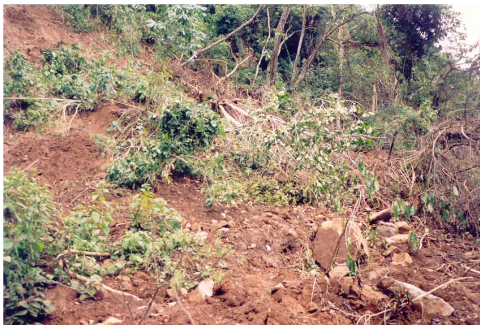
Derrumbe existente en la brecha.
