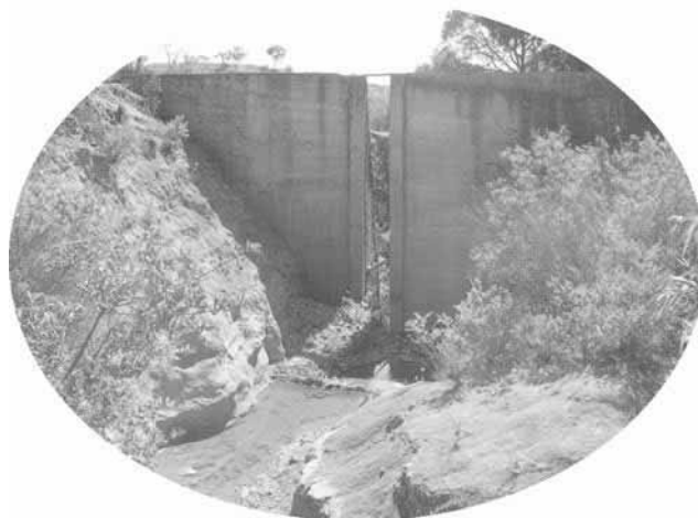
FIGURA 16. REPRESA PARA RETENCIÓN DE AGUA PARA RIEGO, NO FUNCIONA DESDE HACE MÁS DE 15 AÑOS.
