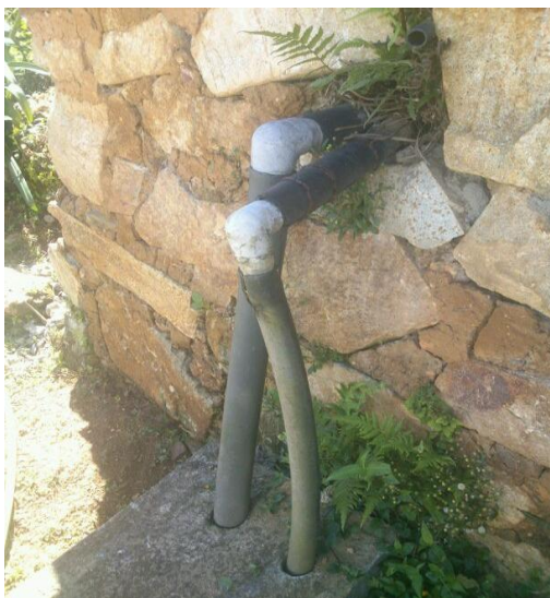
Figura 15. Sistema de Agua potable actual en las Delicias, Agencia de San Juan Juquila Vijanos.
