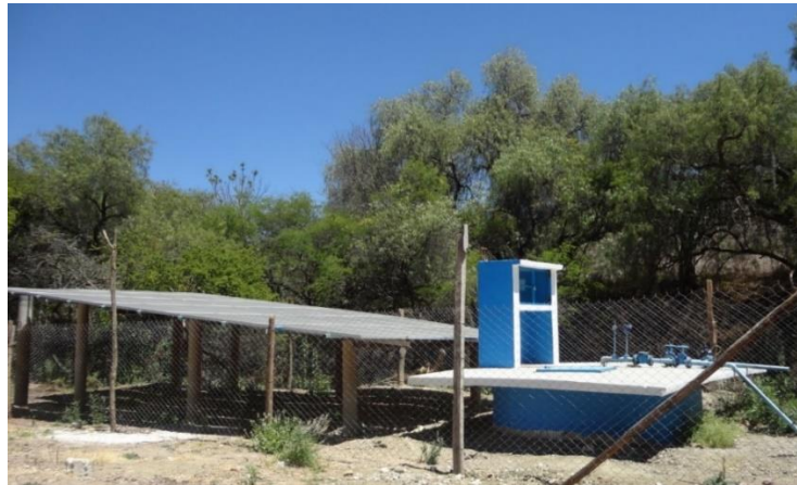
Fig. 33 Pozo con paneles solares.
