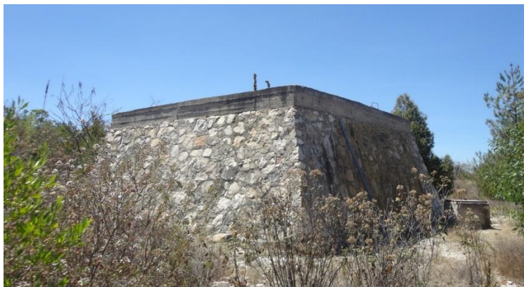
Fig. 41 Tanque de almacenamiento del agua potable.
