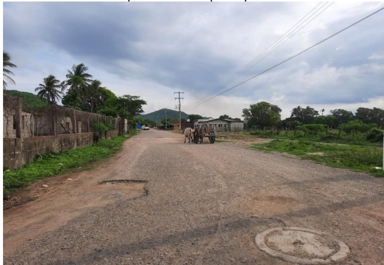
Foto 20. Caminos internos pavimentados que requieren inmediata rehabilitación
