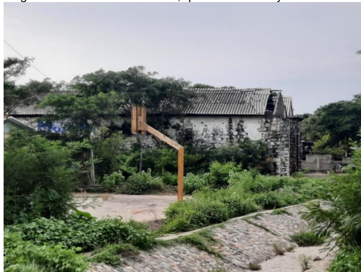
Foto 17. Bodega de la extinta CONASUPO, que no se utiliza y deteriora aceleradamente
