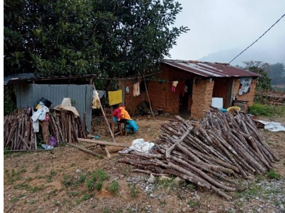
Ejemplo de casa habitación construida con materiales endebles que presenta daños por vientos y humedad.
