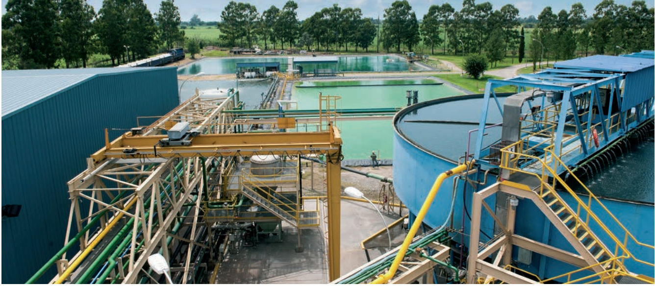
Vista de la Planta de Filtros, ubicada en Tucumán, donde se seca el concentrado y se realiza el tratamiento del agua, cuyo control de calidad se realiza en nuestro laboratorio que cuenta con la acreditación ISO 17025.
