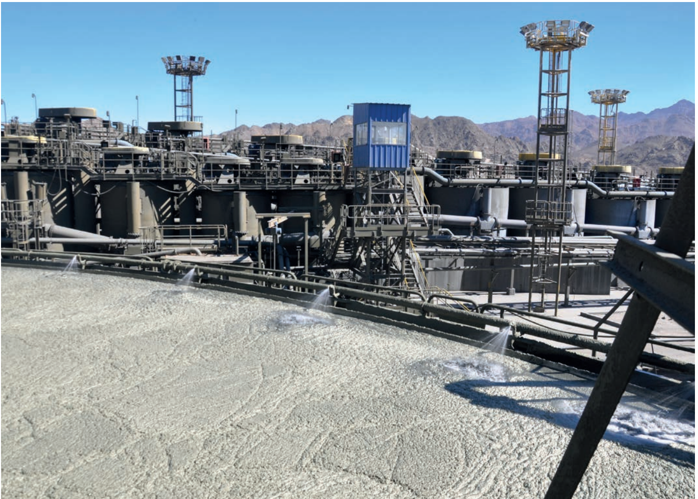
Los espesadores del concentrado se utilizan para alcanzar 65% de sólidos antes de ser bombeado por el mineraloducto.
