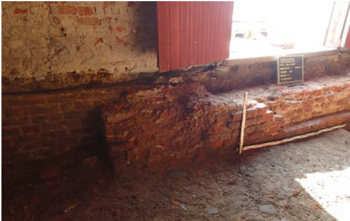
Fig. 4.2: S18, met een abrupt einde, voor de fundering (S21) van de zuidelijke muur (S16).
