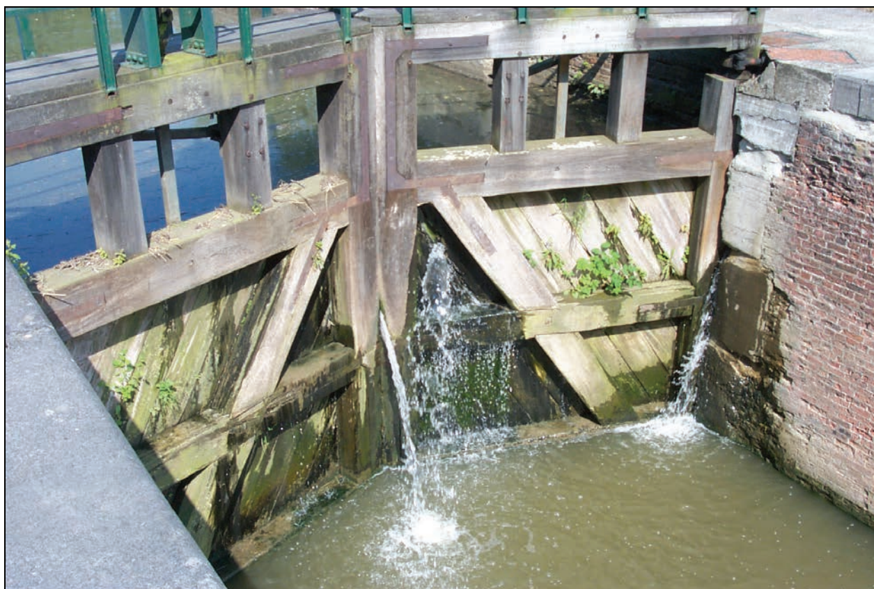
Figuur 134 Afwaartse sluisdeur te Pollare
