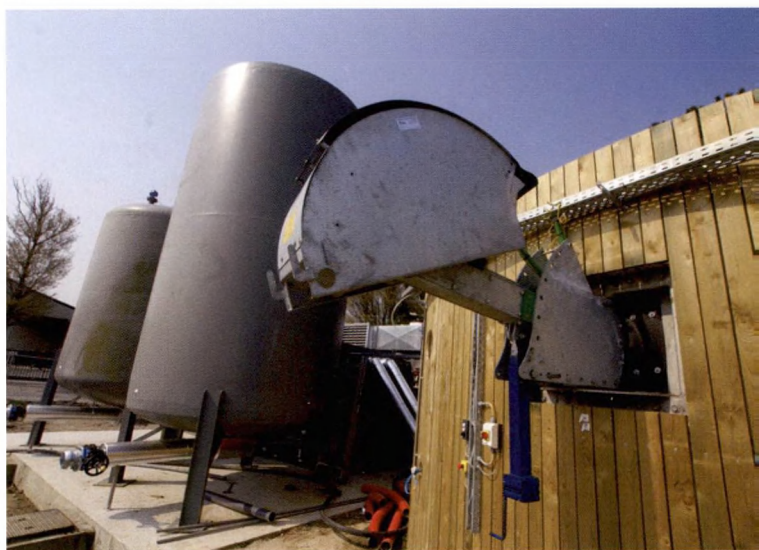
De biogasinstallatie in het POVLT.
