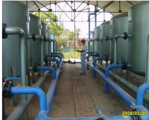
Fuente: Dirección Técnica - Aguas del Cesar S.A. E.S.P.
