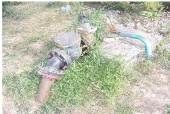
Fuente: Dirección Técnica - Aguas del Cesar S.A. E.S.P.
