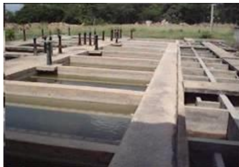
Fuente: Dirección Técnica - Aguas del Cesar S.A. E.S.P.
