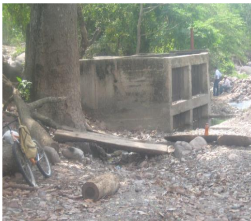
Fuente: Dirección Técnica - Aguas del Cesar S.A. E.S.P.
