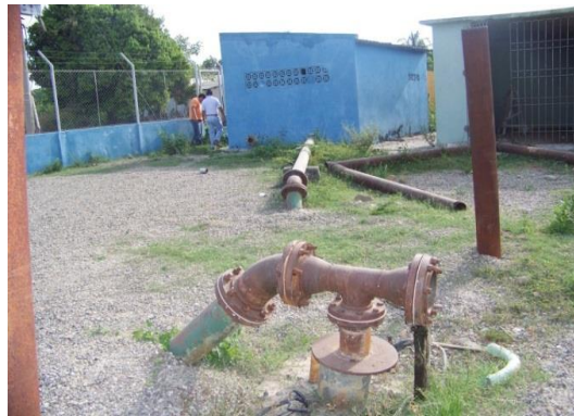
Fuente: Dirección Técnica - Aguas del Cesar S.A. E.S.P.
