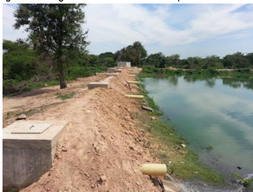
Fotografía 6. Lagunas de Oxidación Municipio de El Paso.
