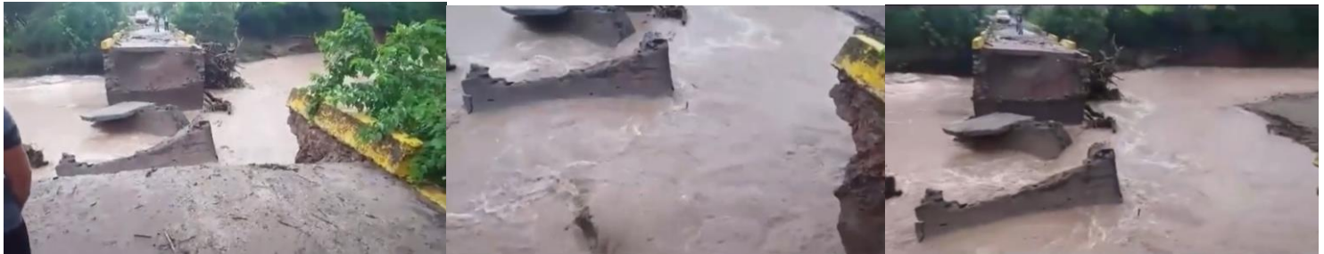
Fotografías del derrumbe del puente en septiembre de 2018, Fuente: página de red social de San Lorenzo Victoria.
