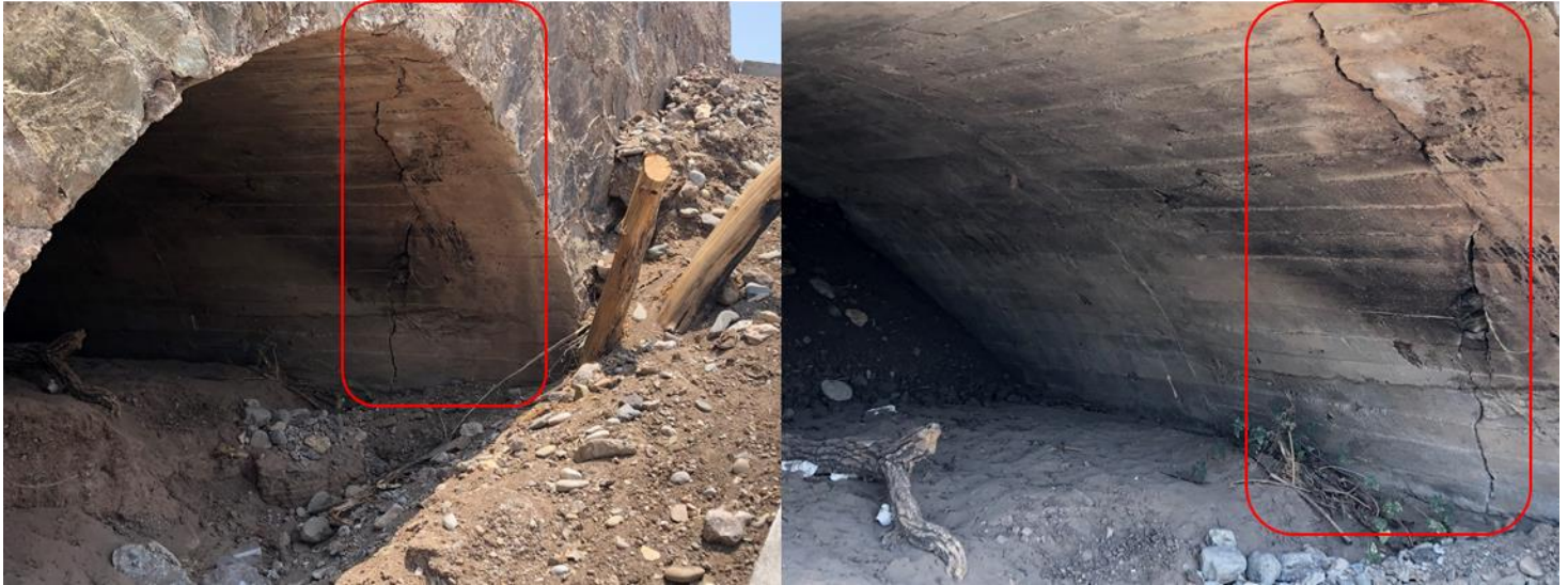
Problemas de fracturación en la estructura en el arco 9.
