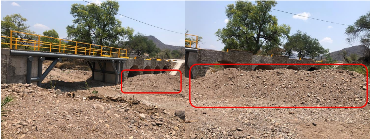
Azolve del cauce del arroyo aguas arriba.
