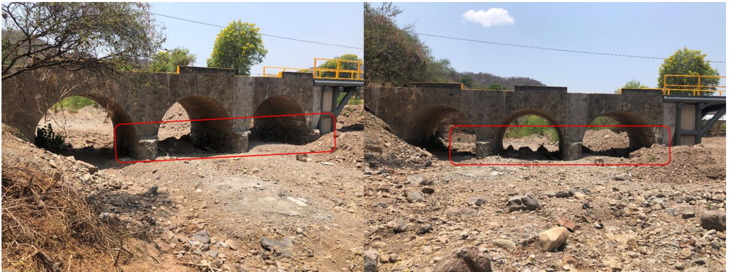
Problemas de socavación en la base de la estructura existente vista aguas abajo.
