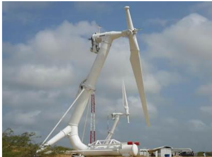
Figura 27. Vista Aerogenerador. Nazareth-Guajira
