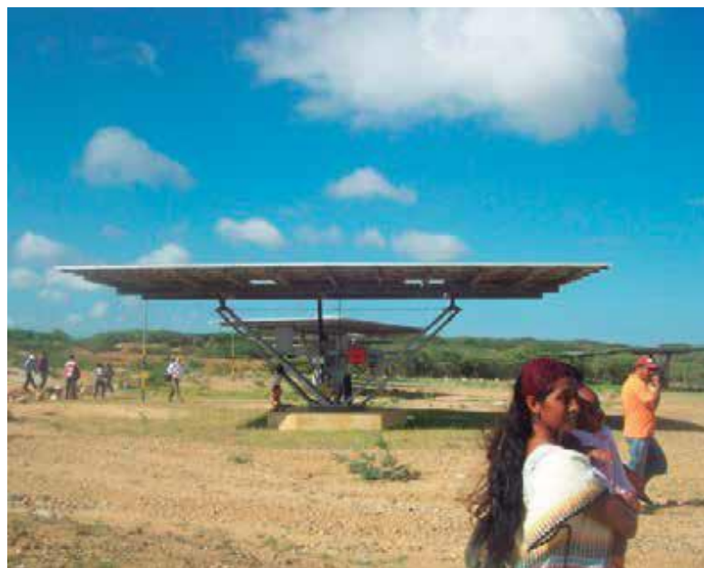
Figura 26. Sistema híbrido solar - diesel, para atender las localidades de Nazareth y Puerto Estrella (Guajira).
