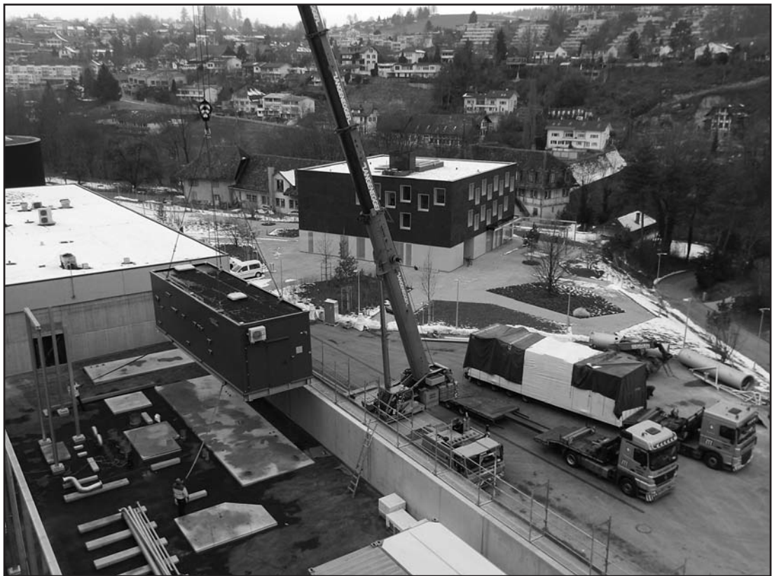
Am 20. Februar 2013 wurden in der arabern die letzten Anlagenteile für die neue Biogasaufbereitungsanlage angeliefert. Die Inbetriebnahme der Anlage erfolgt voraussichtlich im Verlauf des Monats April. (Bild: arabern)
