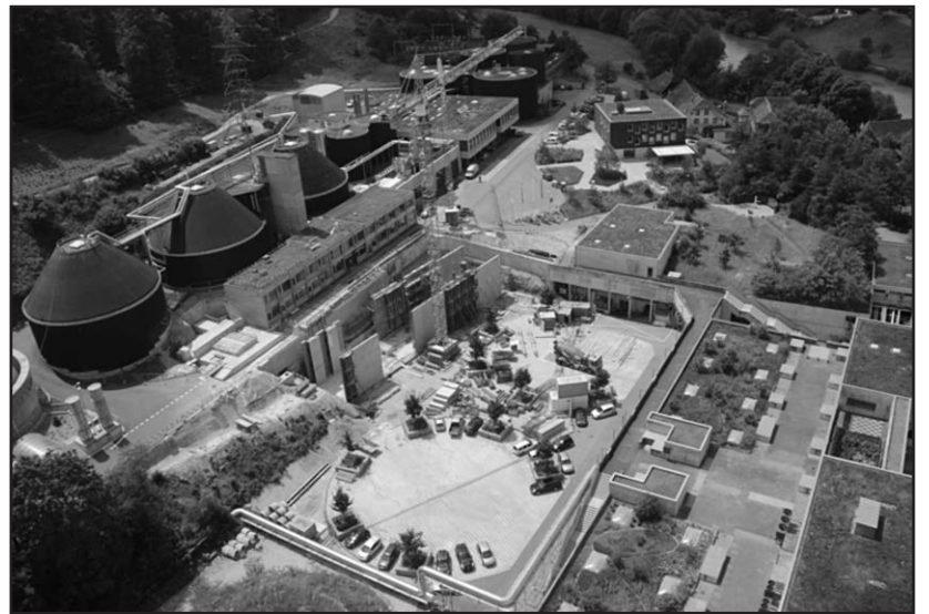
Blick auf die Baustelle: In der Bildmitte die Rücklaufbehandlungsanlage, die sich noch im Bau befindet. (Bild: arabern)
