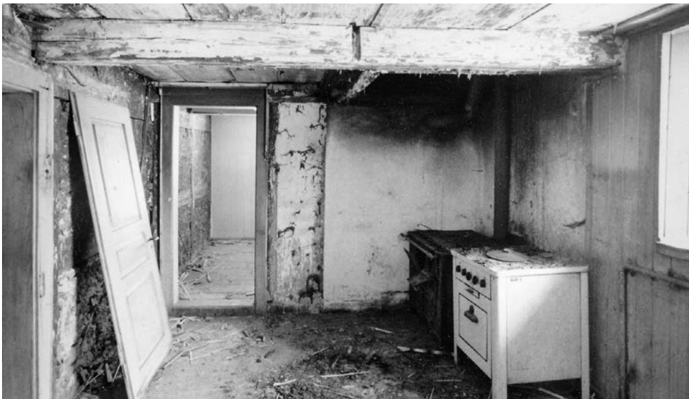
13 Im Unterschied zum Obergeschoss waren die Trennwände rund um die Küche im Hauptgeschoss in einer Fachwerkkonstruktion ausgeführt. Foto, 1982 (FLM AltA 535).
