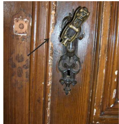
fig. 255: Kleine beschadigingen op een vleugel deur in de vestibule, eigen foto april 2010
