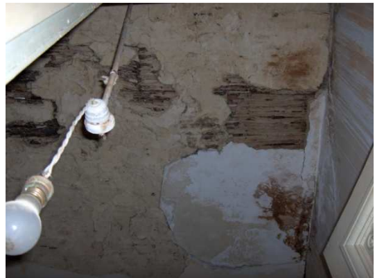
fig. 203: Schade aan plafond van ruimte 11, eigen foto januari 2010
