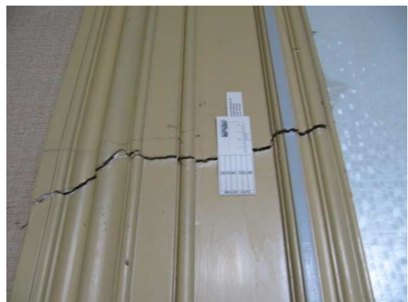
fig. 183: Scheuren in trompe l'oeil deur, eigen foto maart 2010
