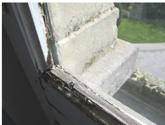
fig. 249: Aangetast deurvenster in de zuidwestelijke zijgevel op de eerste verdieping, eigen foto april 2010
