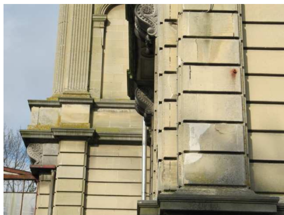
fig. 80: Schade aan de gevelbekleding, eigen foto maart 2010
