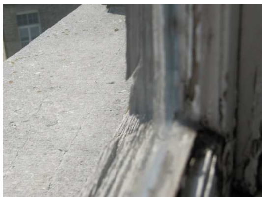
fig. 248: Aangetaste onderdorpel van een zuidwestelijk rondboogvenster op de eerste verdieping, eigen foto april 2010
