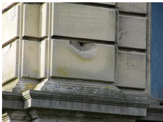
fig. 79: Afgebroken stuk kalkzandsteen, eigen foto maart 2010
