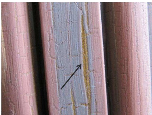
fig. 232: Vleugeldeur in ruimte 4 op de gelijkvloerse verdieping, zichtbare sporen van een eiken imitatieschildering onder de toplaag, eigen foto april 2010
