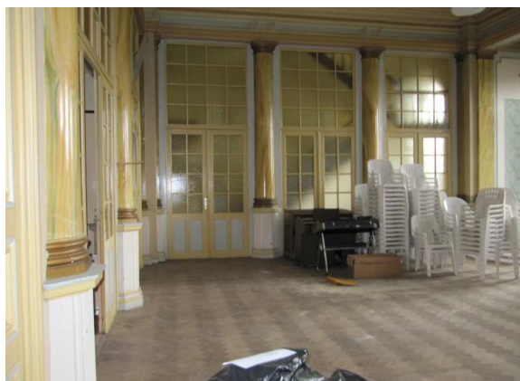
fig. 172: Zicht op de afscheiding en de achterliggende diensttrap in de salle de billard , eigen foto november 2009
