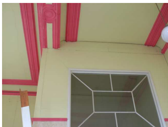
fig. 185: Toegevoegde wanden onderbreken oorspronkelijk lijstwerk en moerbalk, eigen foto december 2009
