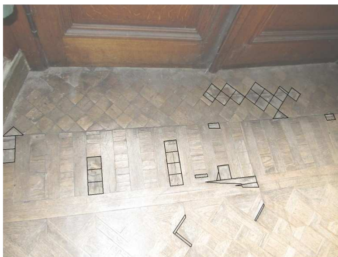
fig. 237: De ontbrekende stukken parket ter hoogte van het deurvenster met de aanduiding hoe het parket dient aangevuld te worden, eigen foto maart 2010
