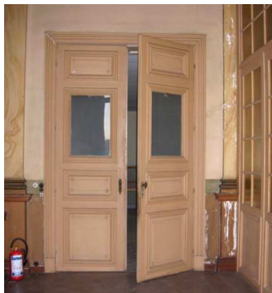
fig. 256: Vleugel deur met een glazen invulling in de salle de billard, eigen foto november 2009
