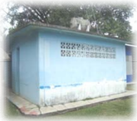
en mal estado
