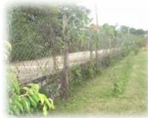
Cercado de malla en mal estado
