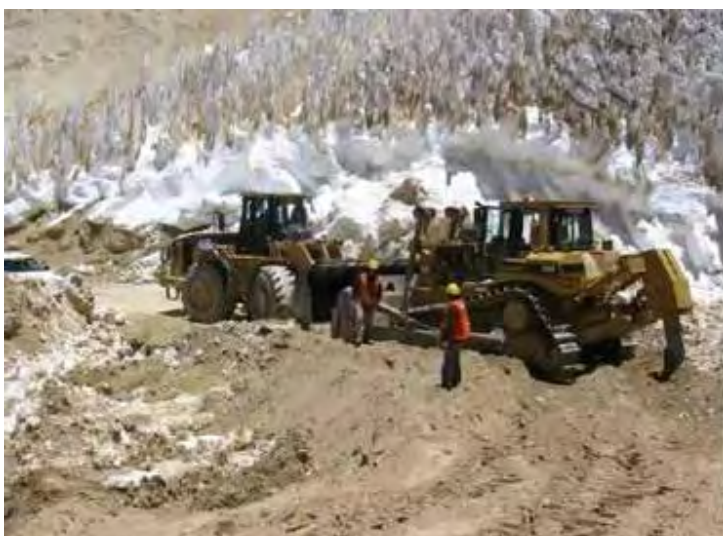
Maquinas viales de Barrick Gold Destruyen Glaciar en Paso Conconta
