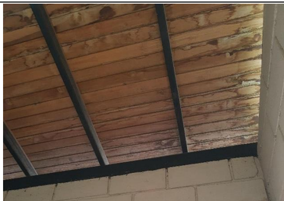
Cubierta de machimbre, con signos de humedad.
