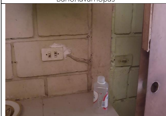
Toma corriente y apagador de la cocina.
