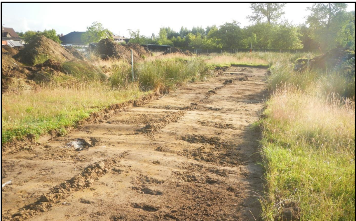
Figuur 18: Gefaseerde afgraving; in dit geval de verwijdering van de ploeglaag gevolgd door een eerste metaaldetectie.
