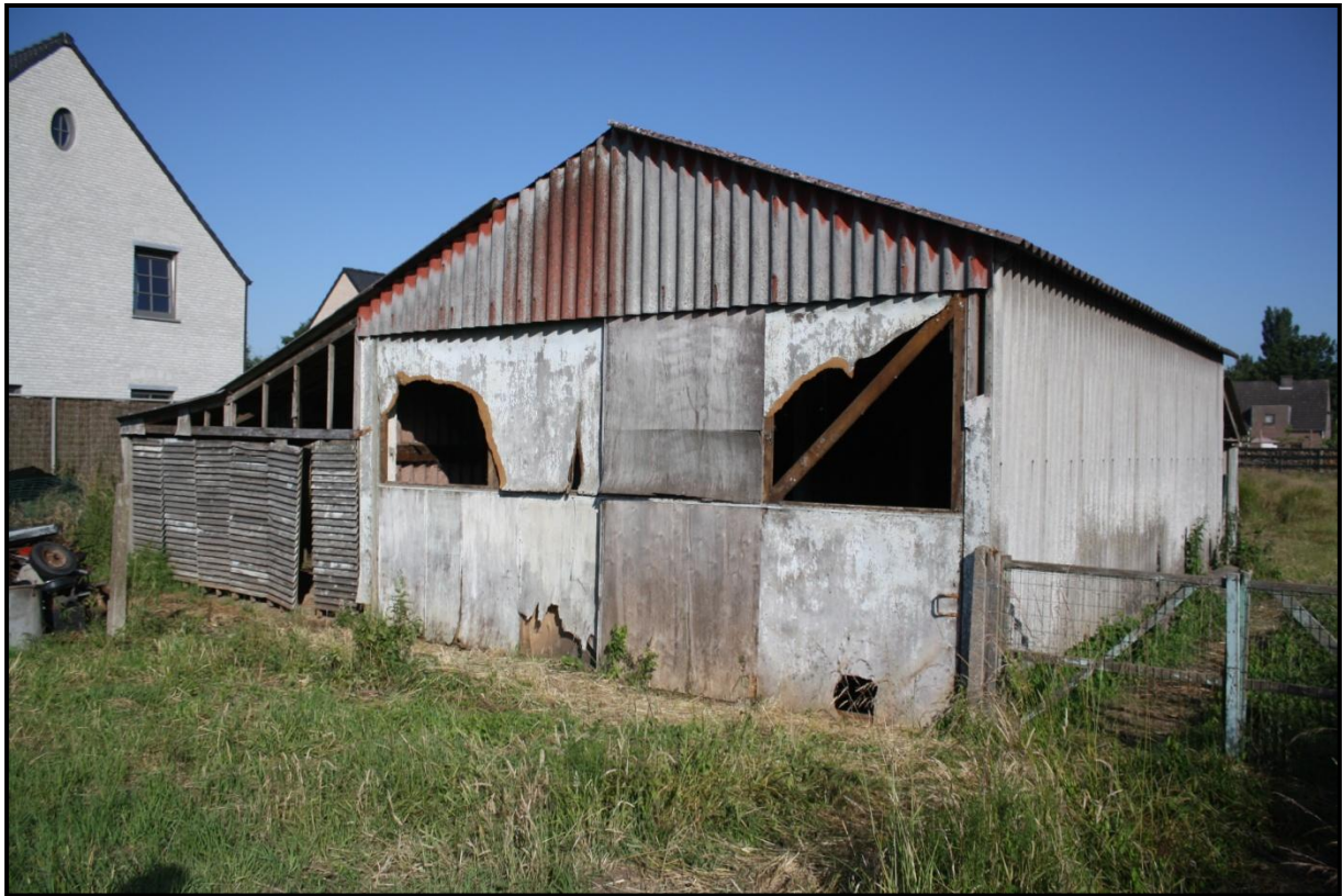
Figuur 14: Zicht op de stalling met mogelijke asbestplaten ter hoogte van de toegang.
