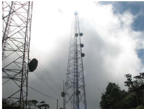
Figura N° 11. Antenas dentro de la cuenca alta del río Bucaral.
