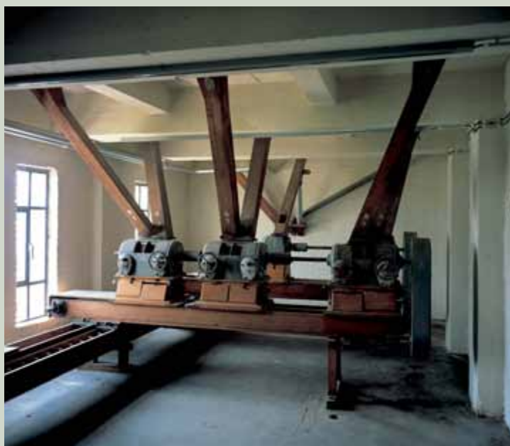
FIG. 132 Menginstallatie van LMS in de Bloemmolens van Diksmuide.
