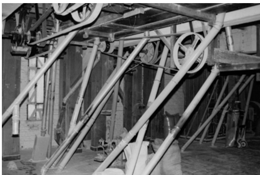
FIG. 98 Pneumatische zuiginstallatie van de firma Henry Simon Ltd in de Bloemmolens van Diksmuide.
