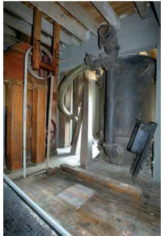
FIG. 103 De ontluftingsketel van de ontstoffingsinstallatie in de Bloemmolens van Diksmuide.
