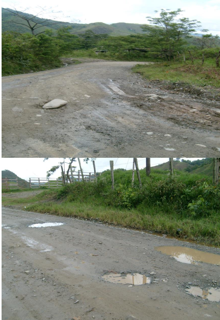
Foto 16. La vía Chaparral - Ríoblanco deteriorada en varios tramos, con pocas obras de arte y sin obras de protección, requiere inversión en obras de drenaje, alcantarillado y pavimentación.
