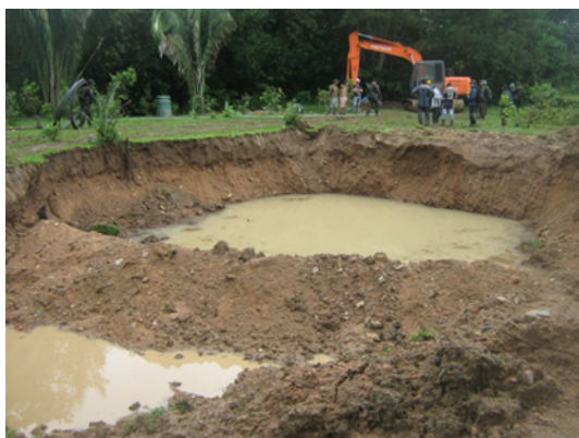
Minería ilegal con retroexcavadora, río Tuluni afluente del río Amoya, vereda Tuluni- Chaparral
