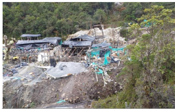
Dstrucción de complejo minero oro de filón, minería subterránea Operativo EIYM, corregimiento Toche, municipio de Ibaqué.
