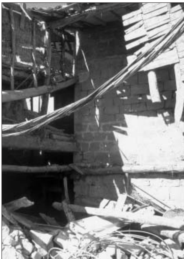
Foto 19. Imagen sacada en el año 1991 tras el accidente de un camión sobre la muralla de fuera que permite apreciar el torreón del ángulo nororiental del recinto, embutido actualmente por edificaciones
