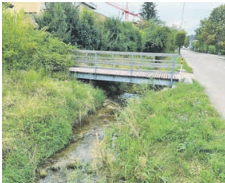
Der Auenbach (hier auf der Höhe der Inneren Auenstrasse) würde ohne Ausbau einem hundertjährigen Hochwasser kaum standhalten. (rh)
