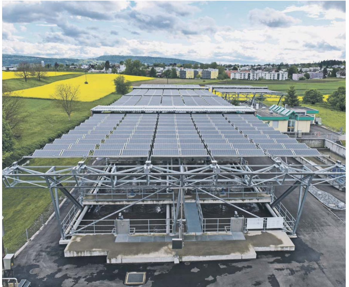
Der Zweckverband Abwasserreinigungsanlage (Ara Eich) in Bassersdorf produziert mit der im Dezember 2020 in Betrieb genommenen Photovoltaikanlage über den Klärbecken grüne Energie. (Archiv)
