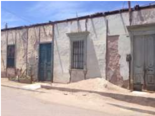
Inmueble muy deteriorado y abandonado
