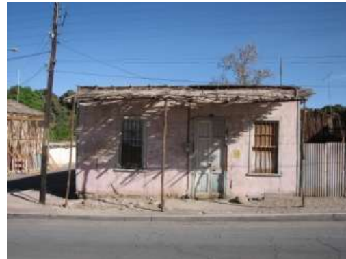
Inmueble muy deteriorado
