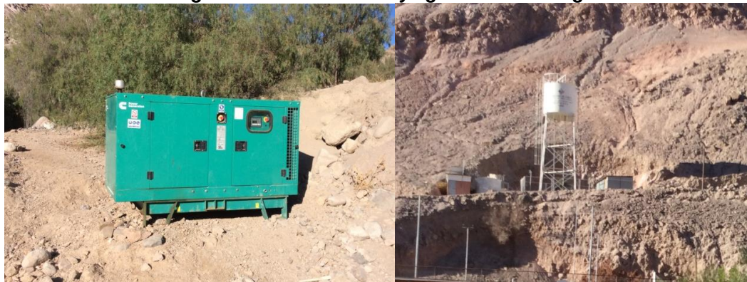
Fotografía 10: Electricidad y agua en Guañacagua
