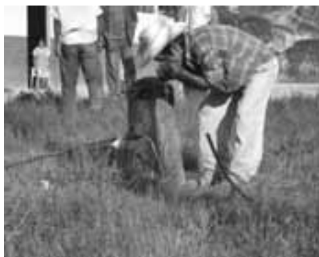
FIGURA 6. INFRAESTRUCTURA DE AGUA ENTUBADA
