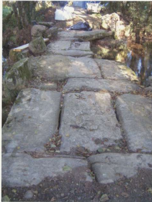
Losas del pavimento, estado actual.
