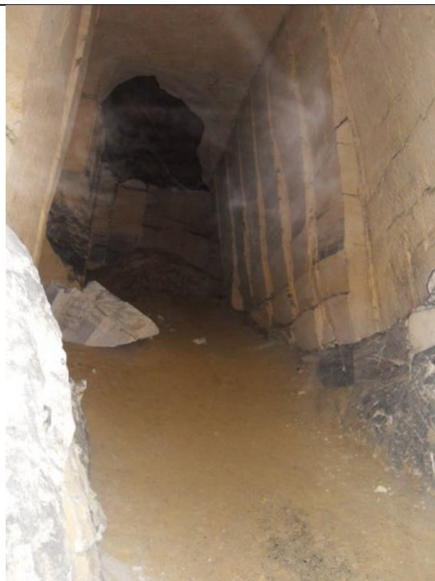
Carrières de tuffeau du Thier de Caster. Vidange d'une importante poche karstique au toit (hauteur de la galerie : 7 à 8 m. Photo SPW, SGW)
