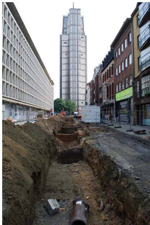
Ill. 9: Door de verschuiving van de rooilijn in de Lombardenstraat kwamen de kelders van de voormalige huizen tijdens de recente bestratings- en rioleringswerken aan het licht. © Stad Antwerpen, dienst archeologie
