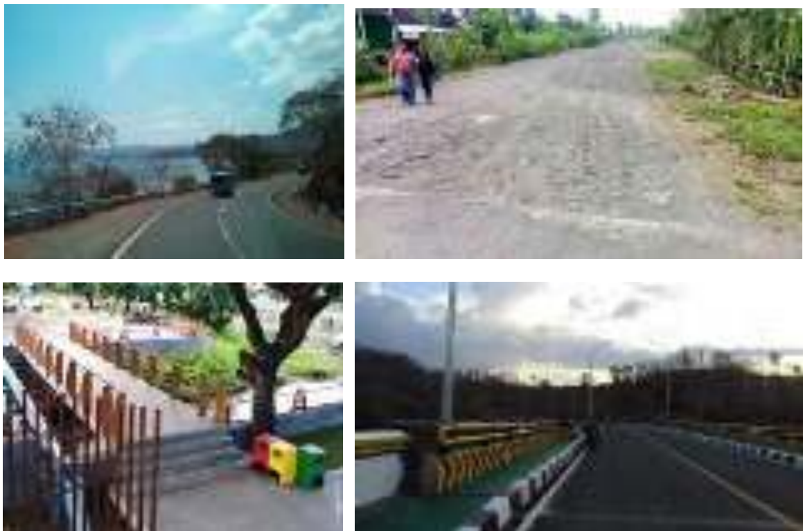
Gambar 4.17 Kondisi Jalan dan Jembatan di beberapa titik di Provinsi Nusa Tenggara Barat
