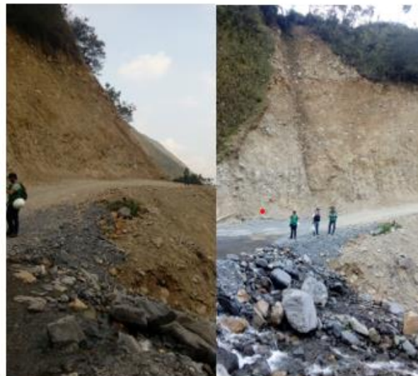
FIGURA 8: Deslizamiento de detritos tramo vial 4006CNGy01, zona Vereda Jaboneras.
