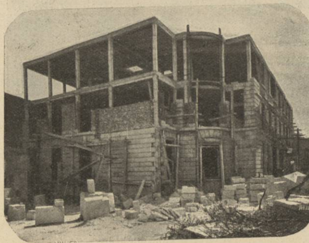
Fig. 10. — Fondations, poteaux, planchers et terrasse en béton armé. Remplissage en pierre de taille.
