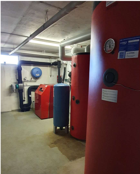
HEIZUNG MIT WÄRMEPUMPE
