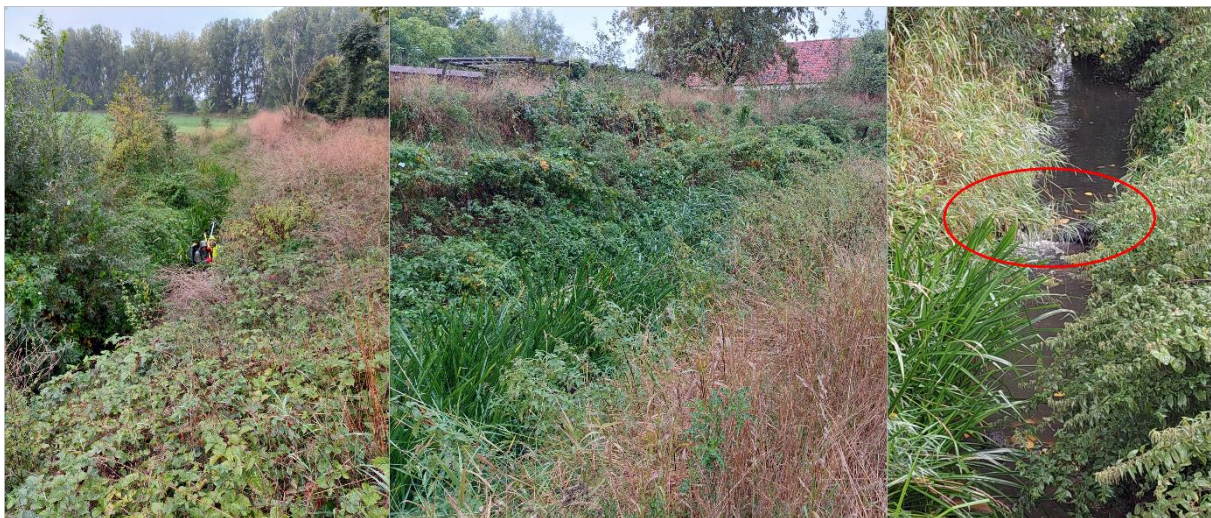
Figuur 9: zicht op de Hertsbergebeek. Links en midden: stroomaf de Sterredreef, met veel plantengroei. Rechts: stroomop Sterredreef met dam (rood omcirkeld). Bron foto: © Mechtild Zoeter Vanpoucke, PCM.
