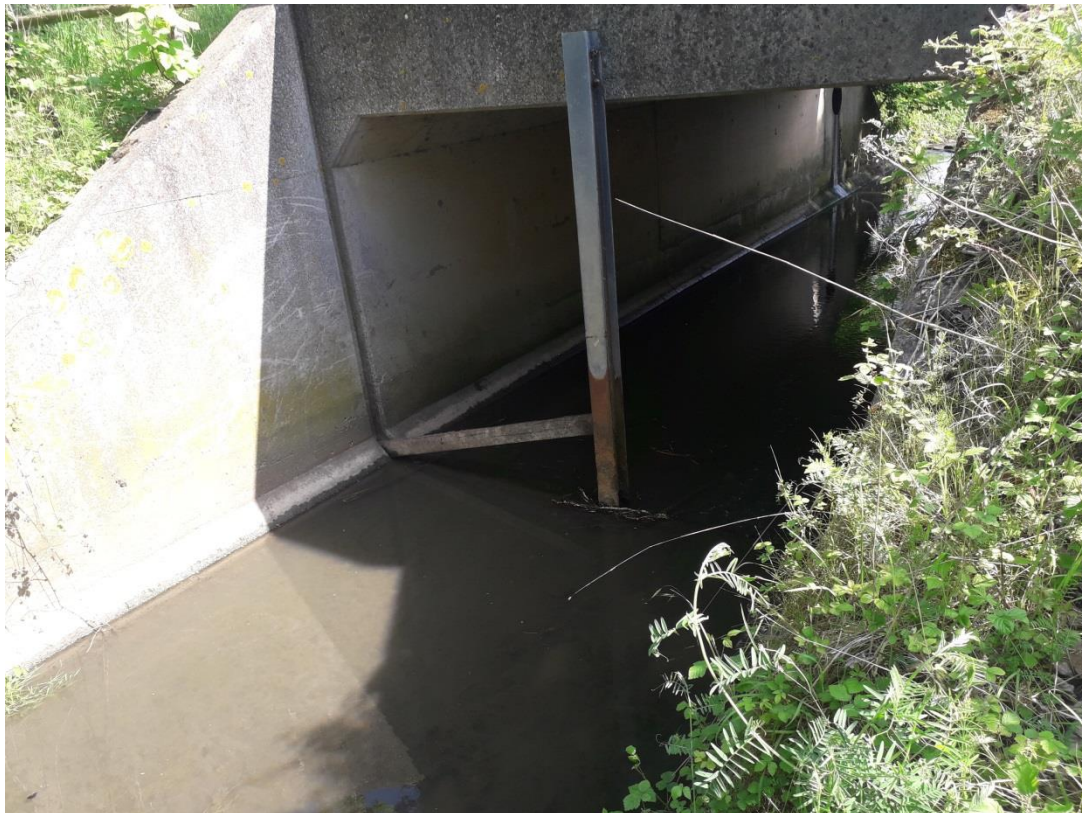
Figuur 10:Knelpunt 1, locatie 430: Balk vlak onder wateroppervlak, aan het begin van de betonplaat onder de brug. Zie ook Figuur 1 en Tabel 10 voor de precieze locatie.
