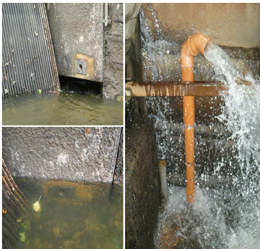
Figure 64. Aménagement d'un exutoire de fond latéral en amont de la grille de protection de la prise d'eau de la centrale hydroélectrique de Méry sur l'Ourthe : (en haut à gauche) vanne latérale soulevée montrant l'orifice de fond percé ; (en bas à gauche) orifice de dévalaison de fond en action dans la vanne latérale pour un niveau d'eau fortement abaissé ; (à droite) tuyau en siphon permettant la capture des anguilles qui utilisent l'exutoire de fond (documents ProFish Technology).
