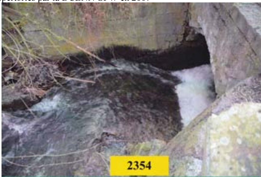
Figure 34 . Principal obstacle qui freine la remontée des anguilles dans le Ruisseau des Awirs à partir de la Meuse. Obstacle de type pertuis situé sous le pont la carrière d'Aigremont. (source : DCENN-SPW).
