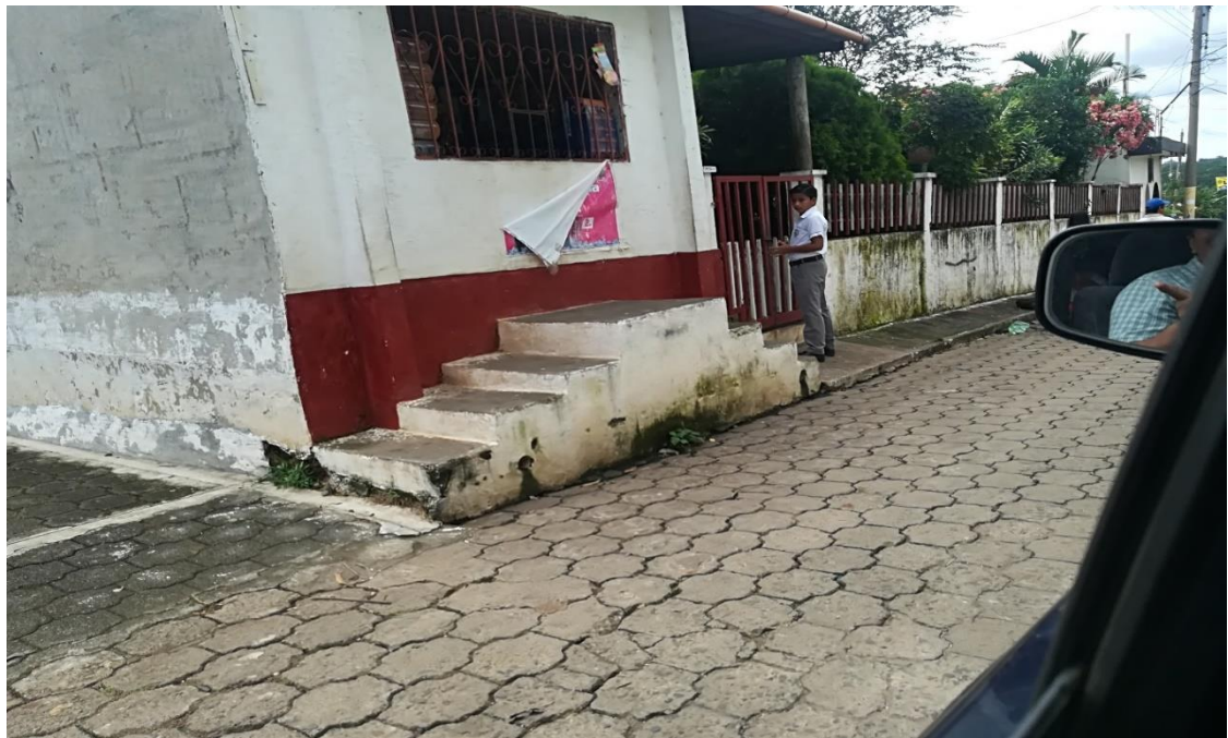
Algunas banquetas o aceras no están diseñadas para personas con discapacidad de movilidad.
