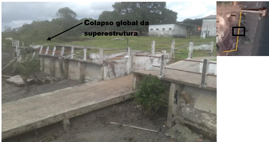
Foto 01: Visão geral da área afetada. Verifica-se no canto superior esquerdo da imagem o colapso da estrutura.
