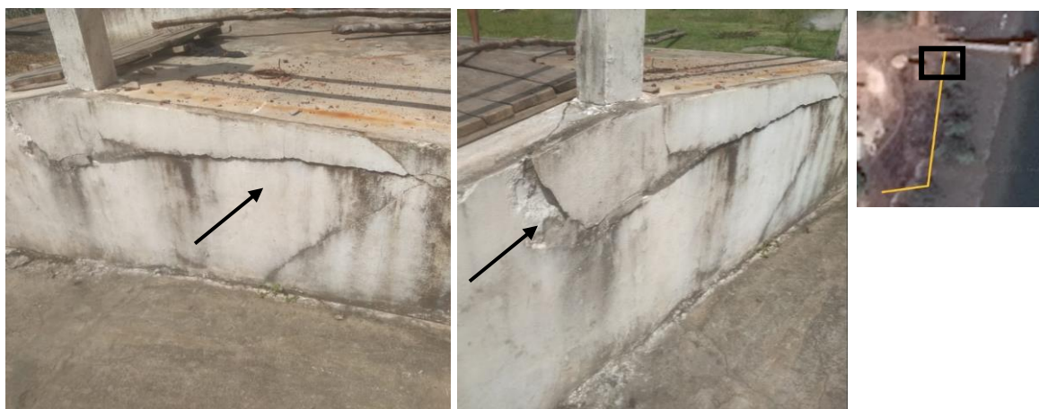
Fotos 03 e 04: Área de acesso a rampa. Para peito com a base trincada proveniente da movimentação da estrutura da calçada.
