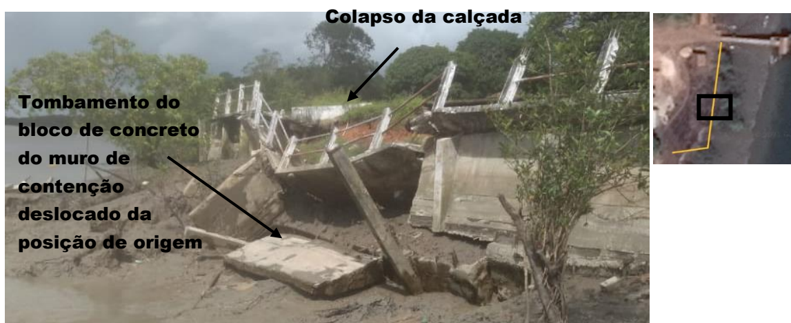
Foto 05: Ponto mais afetado pela ação da erosão do solo.
