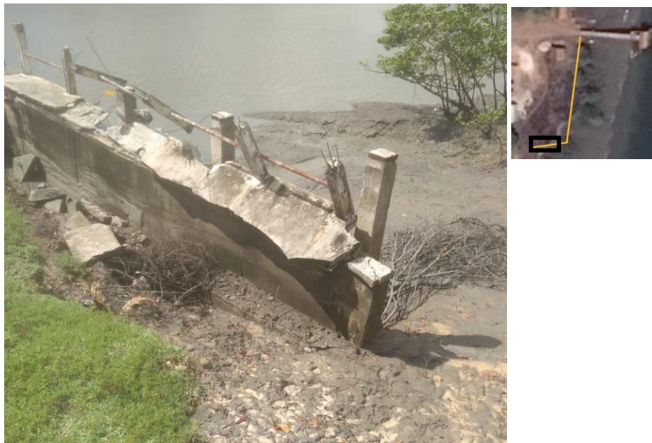
Foto 11: Perda completa da calçada de passeio e perda de solo.
